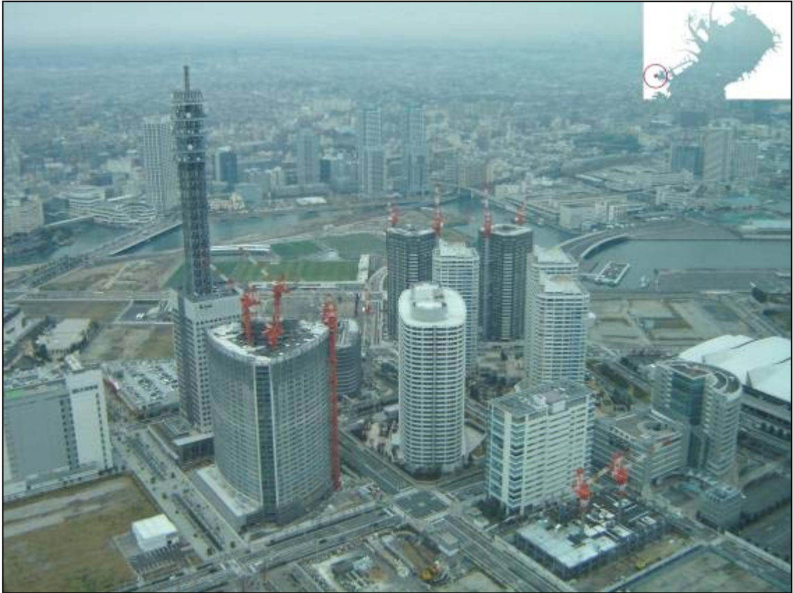
Photo 21 : Forêt de kôsho manshon en cours de construction sur Minato Mirai 21 zone centrale. © R. Scoccimarro 2007.
