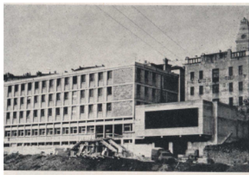
Bâtiment de la future Maison de l'Agriculture (en construction) « Bâtiment de la future Maison de l'Agriculture (en construction) », 4 avenue de l'Europe Unie, Privas, 1964 ( Annuaire APCA 1964 )
