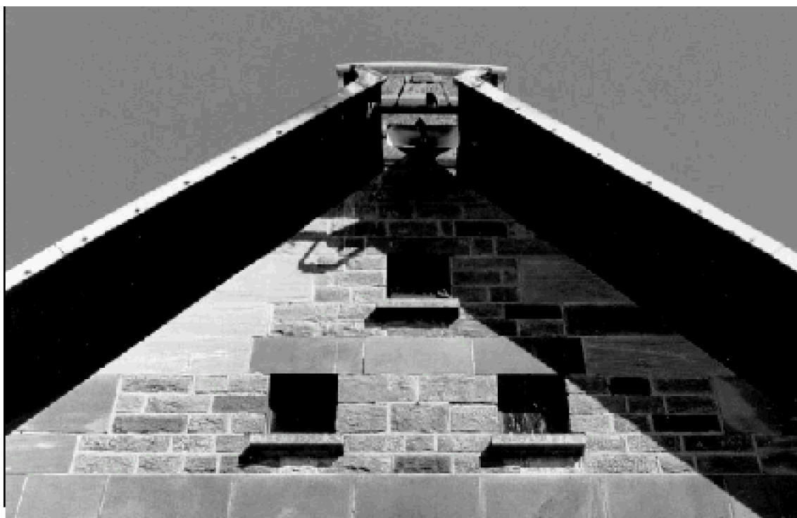
Fig. 107 : Détail du système d'éclairage zénithal pris au niveau du faîte de la toiture. Eglise Notre-Dame, Behren-Lès-Forbach. E. Voltz et Ch. Sommermatter architectes, J. Prouvé constructeur.
