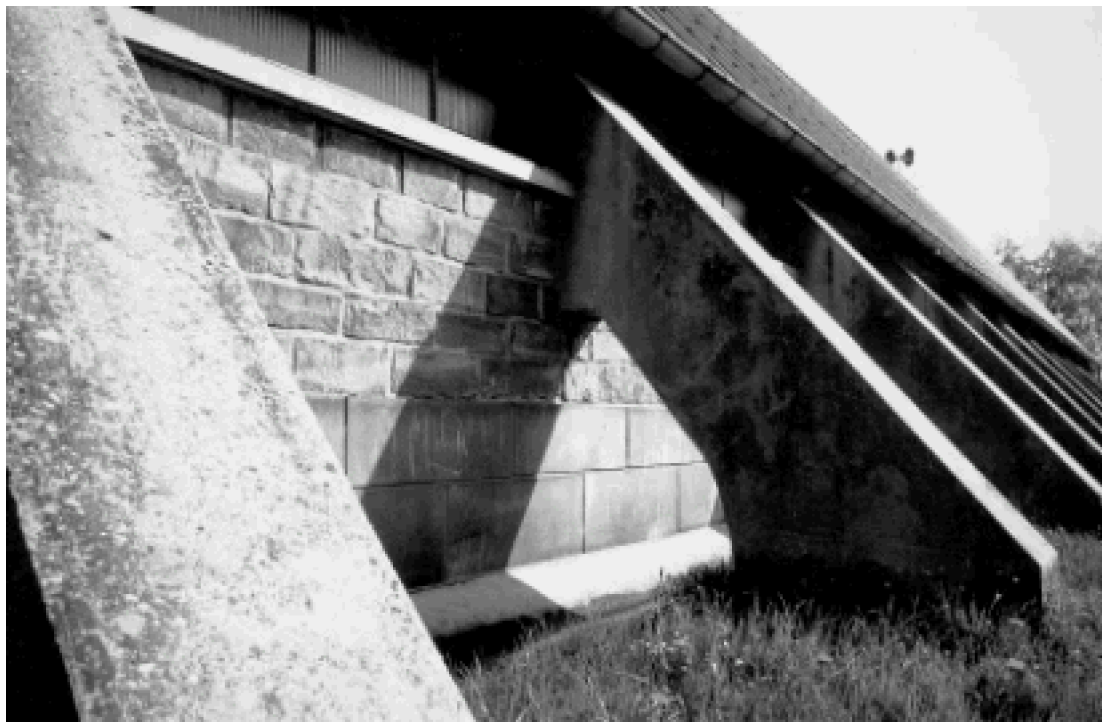
Fig. 111 : Détail des arcs-boutants en béton armé de l'église du Christ-Roi à Forbach. E. Voltz et Ch. Sommermatter architectes, J. Prouvé constructeur.
