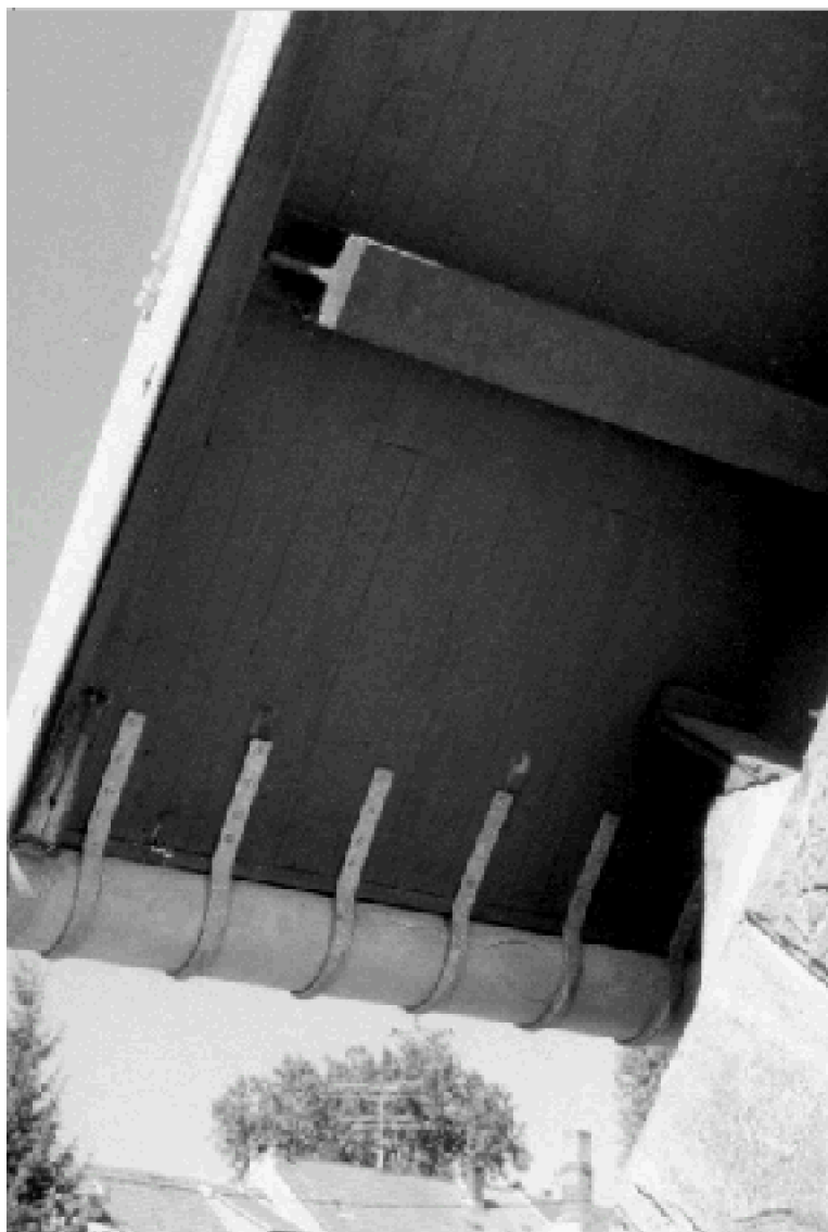
Fig. 106 : Détail des plateaux de bois de la couverture supportés par les pannes de la charpente métallique de l'église du Christ-Roi à Forbach. E. Voltz et Ch. Sommermatter architectes, J. Prouvé constructeur.
