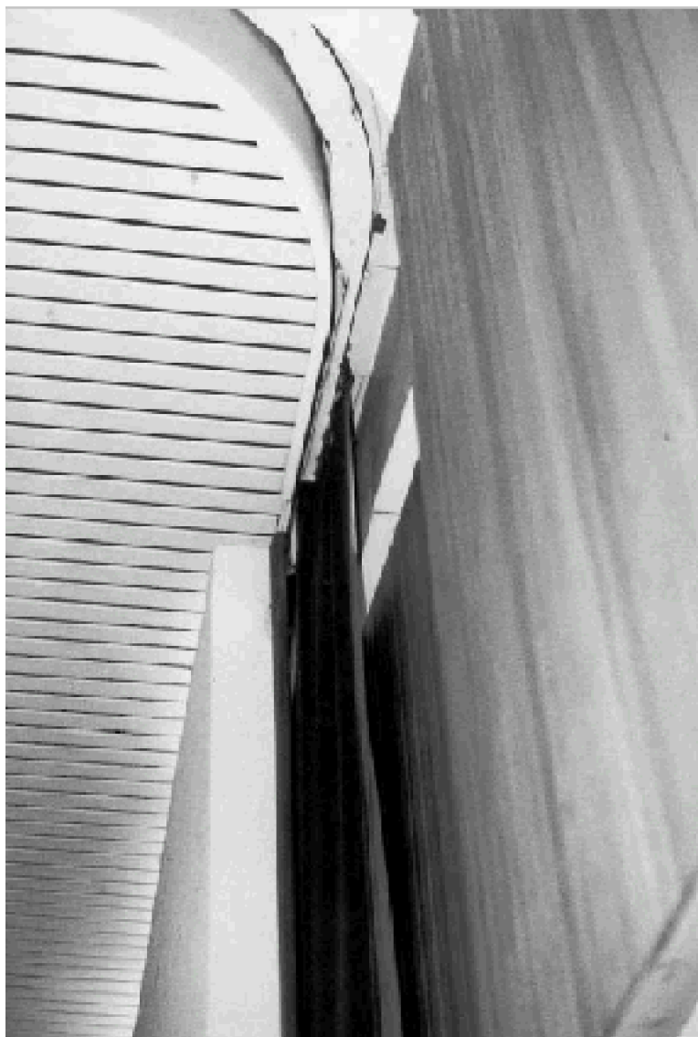
Fig. 180 : Détail du dispositif d'accrochage et de rangement du rideau du Centre Paroissial Saint-Joseph-Ouvrier à Creil.
