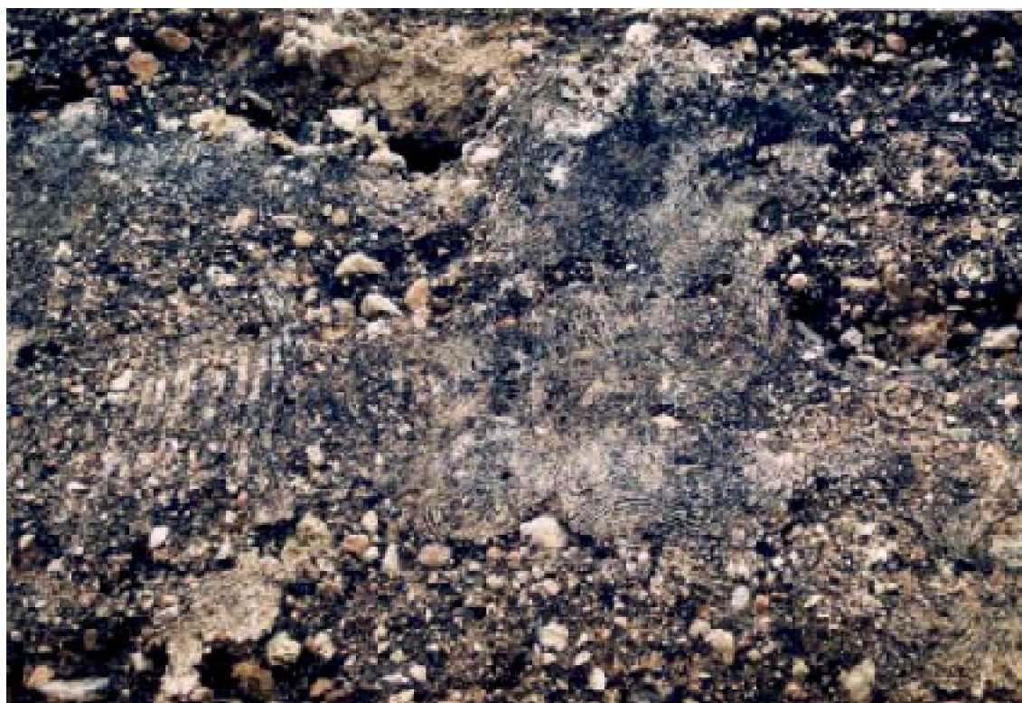
B : Détail de l'enduit qui couvre les murs en □ □ biya de S□r Ban□ M□guir.
