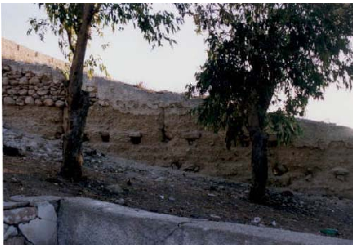
B : Quelques caissons de □ □ biya de l'enceinte almohade. Des reprises en pierre ont été effectuées sur quelques parties du tronçon.
