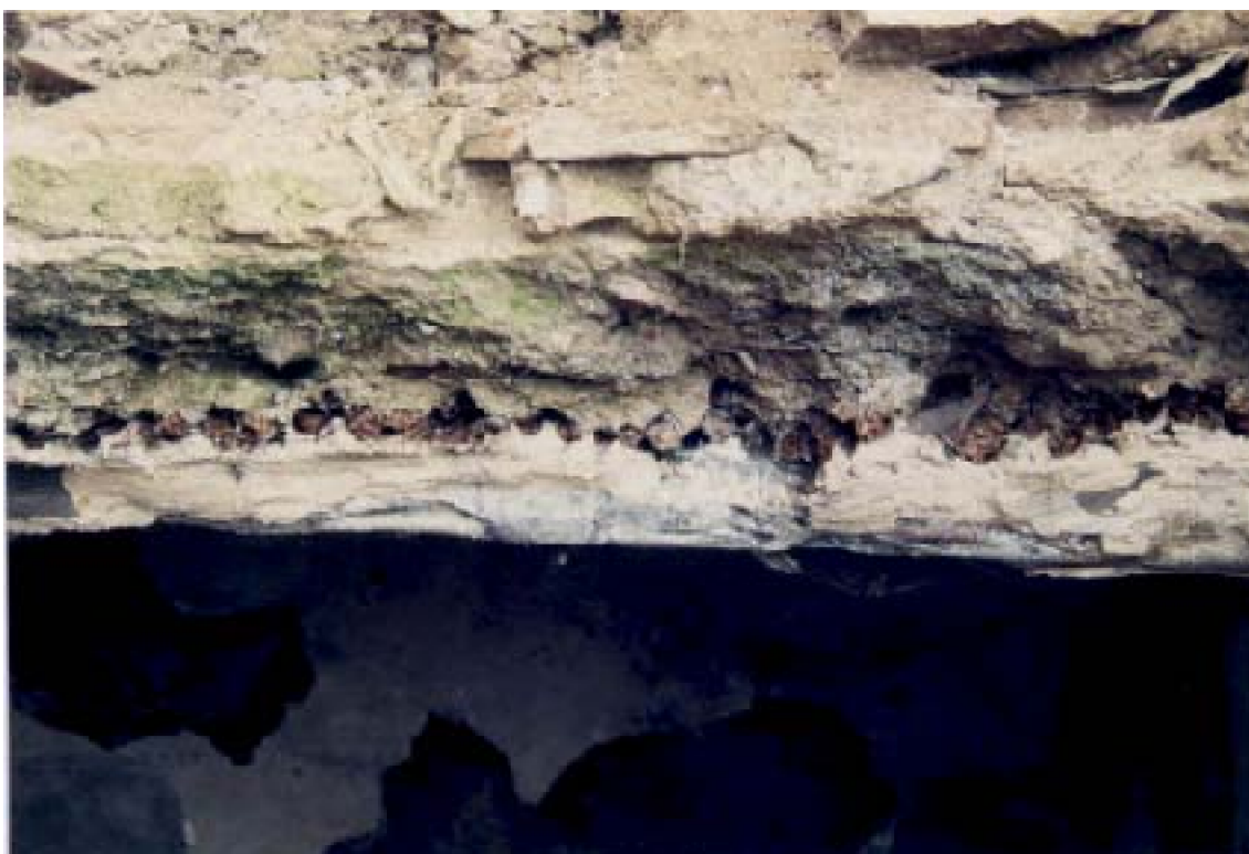
B : Coupe d'une toiture de tchwit (Safi). Les poutres reçoivent des petites solives en rang serré, avant la mise en oeuvre de la toiture.
