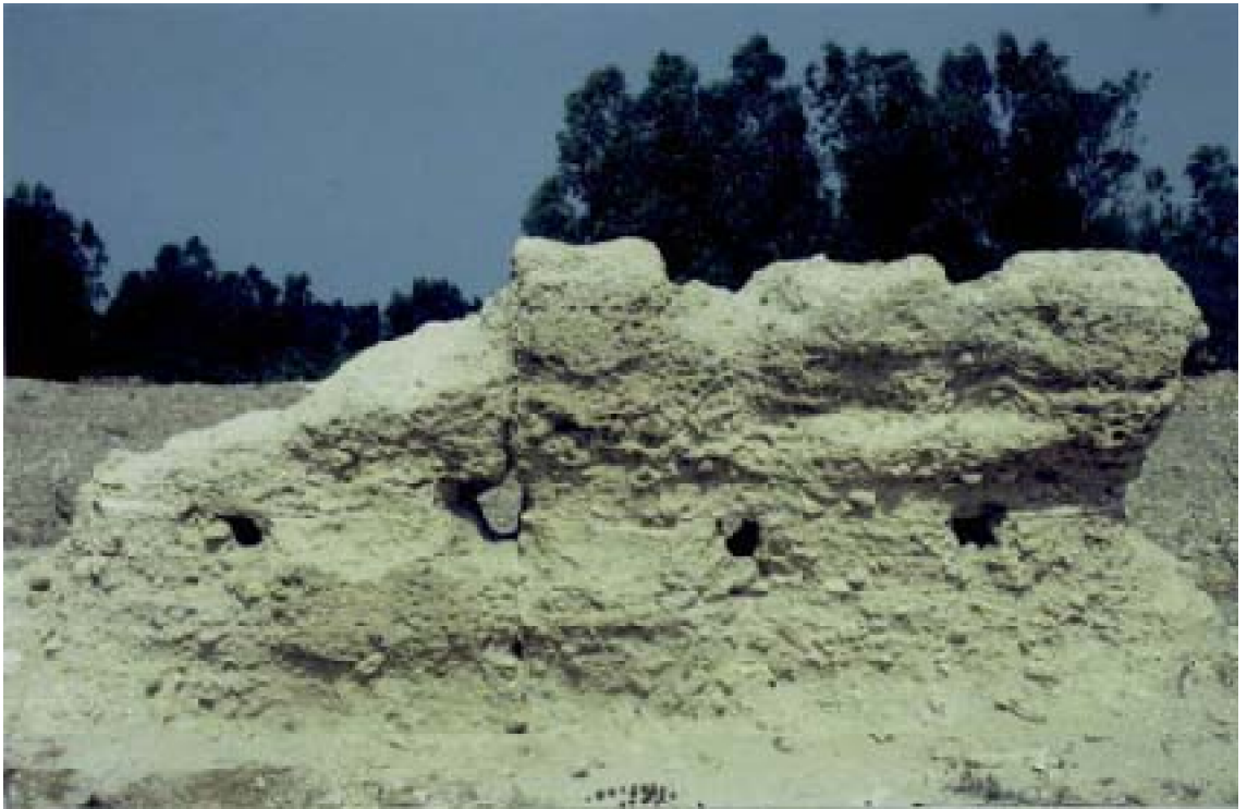
B : Restes d'un mur en \square \square biya, côté de la muraille. La qualité médiocre de la construction, constatée déjà au 14 e siècle par Ibn al-Kha \square \square b, serait à l'origine de la disparition de la grande partie de l'enceinte.
