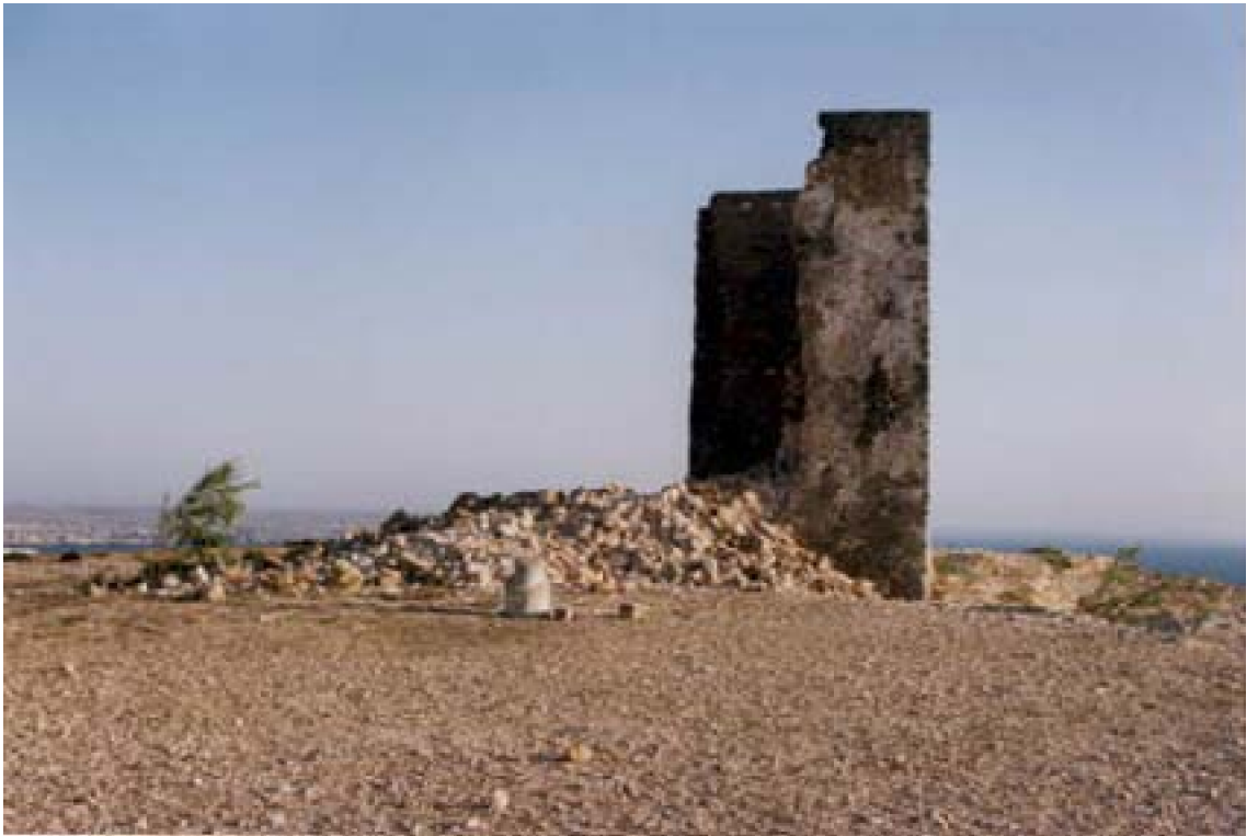
B : La médiocrité des travaux entrepris et les lourdes interventions inappropriés ont fini par accélérer la dégradation du site au lieu de le protéger. La façade s'est écroulée au début de l'année 2003 suite à des intempéries, emportant la voûte qui couvrait la pièce du rez-de-chaussée.
