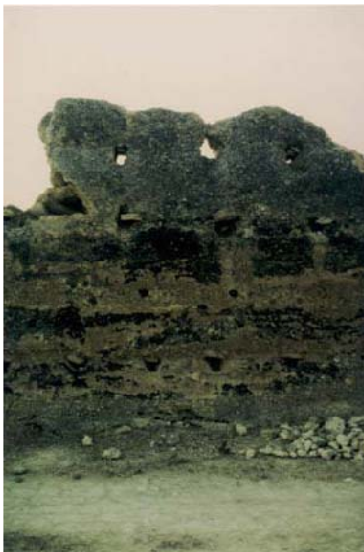
Fig. 104 Al-Madīna A : Vue du côté est de la muraille. La biya est protégée par un enduit.
