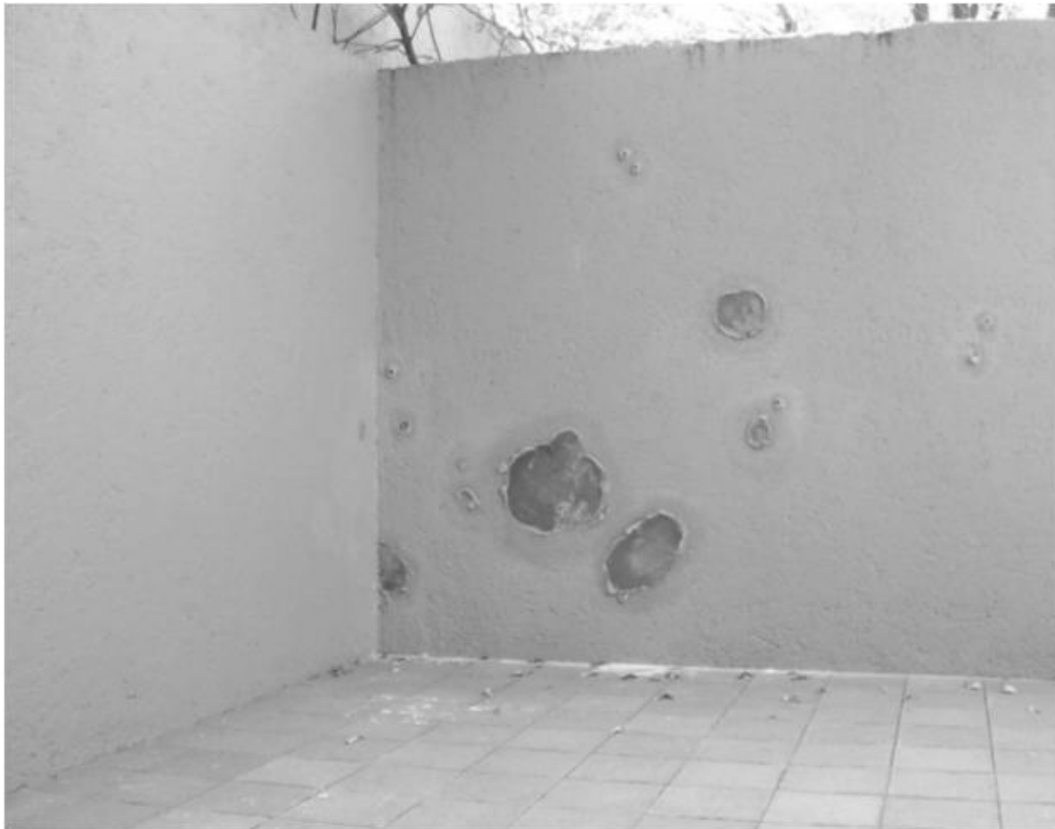
Figure 32 : « mur souffrant ». Note* .
