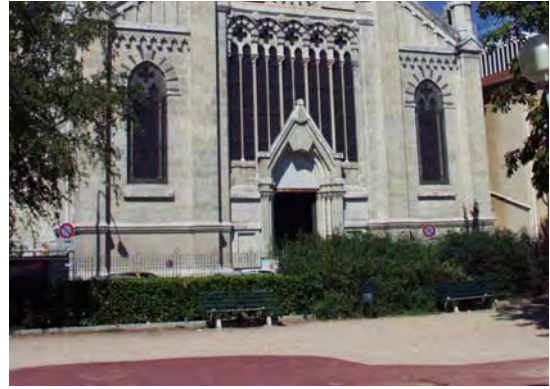
ill. 289 - Façade de l'église du Saint-Sacrement, vue des ornements architecturaux inachevés.
