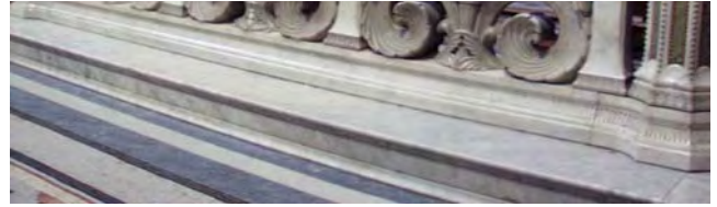
ill. 119 - Partie droite de la table de communion du chœur de la basilique de Fourvière.
