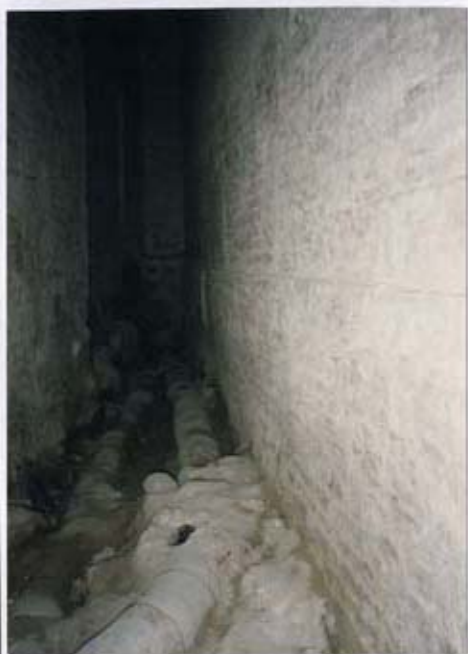
Pl.16. Couloir dans le répartiteur de Lakhnizra accueillant deux lignes de canalisations
