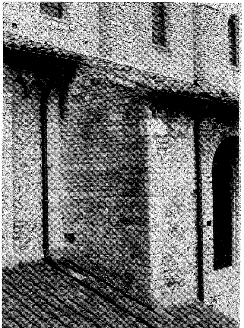
102. Tournus, église abbatiale Saint-Philibert : détail du raccord de l'avant-nef avec la nef élargie, du côté sud (au-dessus du toit du parloir)
