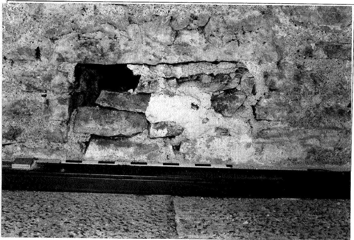
136. Partie haute d'une ancienne fenêtre bouchée, dans le mur occidental du cellier (vue depuis l'intérieur de la salle supérieure actuelle)
