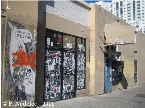
Paysage emblématique du déclin économique du centre-ville, ces deux locaux commerciaux sont laissés à l'abandon depuis plusieurs années, comme l'indiquent les graffitis et le mauvais état des façades. Localisation : 102 6th Street.
